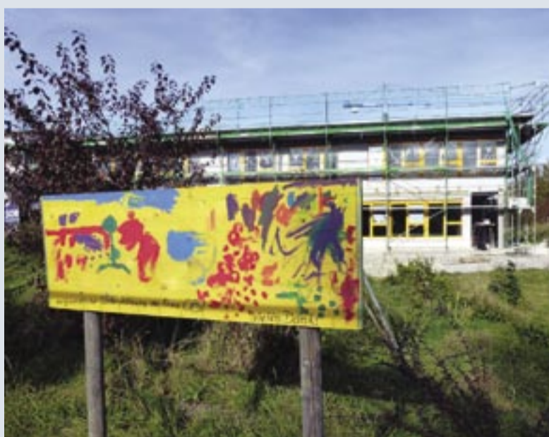
Mit bunt bemalten Tafeln, zur Verfügung gestellt vom Obi-Baumarkt in Füssen, zeigen die Kinder ihre Vorfreude auf den Umzug in die neue Kindertagesstätte in der Hiltepoldstraße und verschönern damit gleichzeitig die Baustelle.
